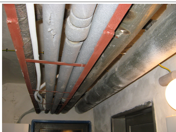
Obr. 2.1.4 – Rozvody UT a TV
